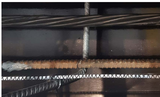
Spannbetonträger mit EpsilonSensor
